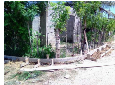
Aceras y contenes destacan en Brizas de Tosa
